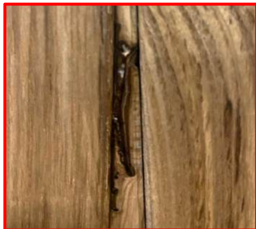
パテ補修不備
